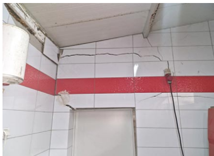
Rys. 4. Pęknięcia ścianek działowych posadowionych na podbudowie betonowej
