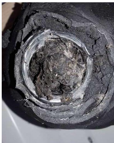
Rys. 4. Zatkana rura wpustu dachowego (fotografia własna)
