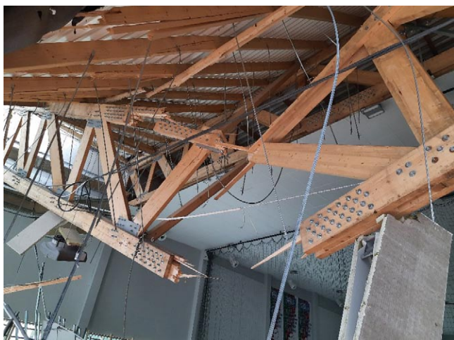
Rys. 3. Zniszczony dźwigar kratowy z widocznym zerwanym stykiem montażowym dolnego pasa (fotografia własna)
