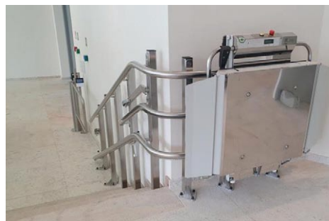
Rys. 4. Platforma schodowa umożliwiająca dostęp na wyższy poziom w budynku osobom poruszającym się na wózku [5]
