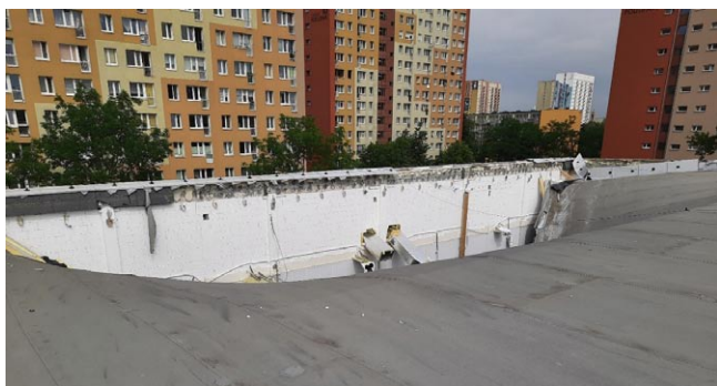
Rys. 1. Widok zniszczonej połączy dachowej (fotografia własna)
